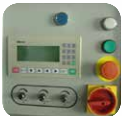
Panel de operación
